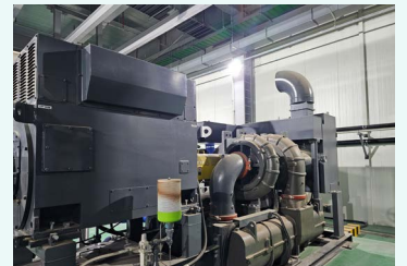
포항 양극재 공장 컴프레서
